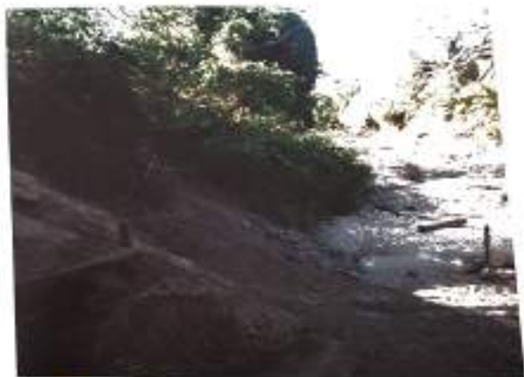
Afectación Río Ranchería
